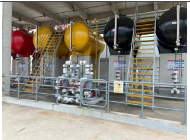
二期酸碱储罐
