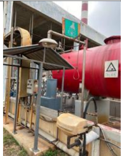
酸碱储罐应急装置
