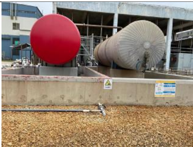
一期酸碱储罐
