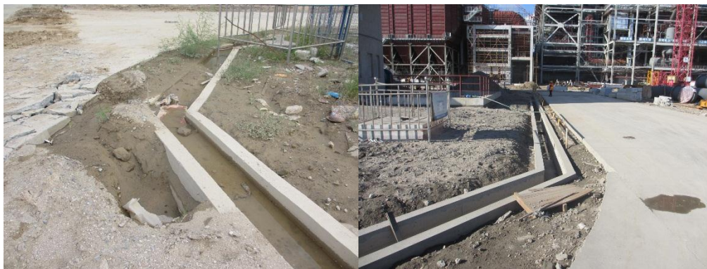
排水沟淤积(2016.8)排水沟清淤后(2016.9)
