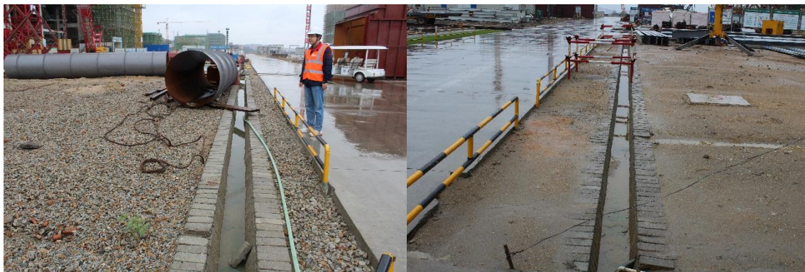
厂区临时排水沟
