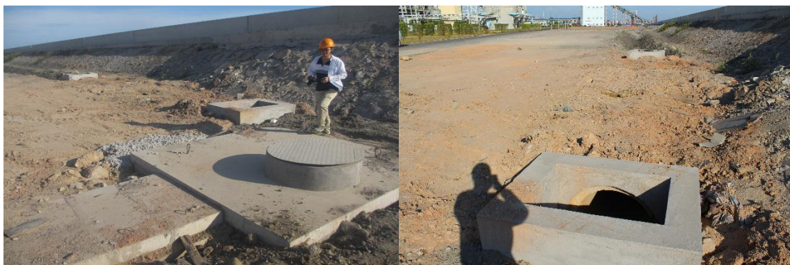
厂内排水沟末端沉沙池
