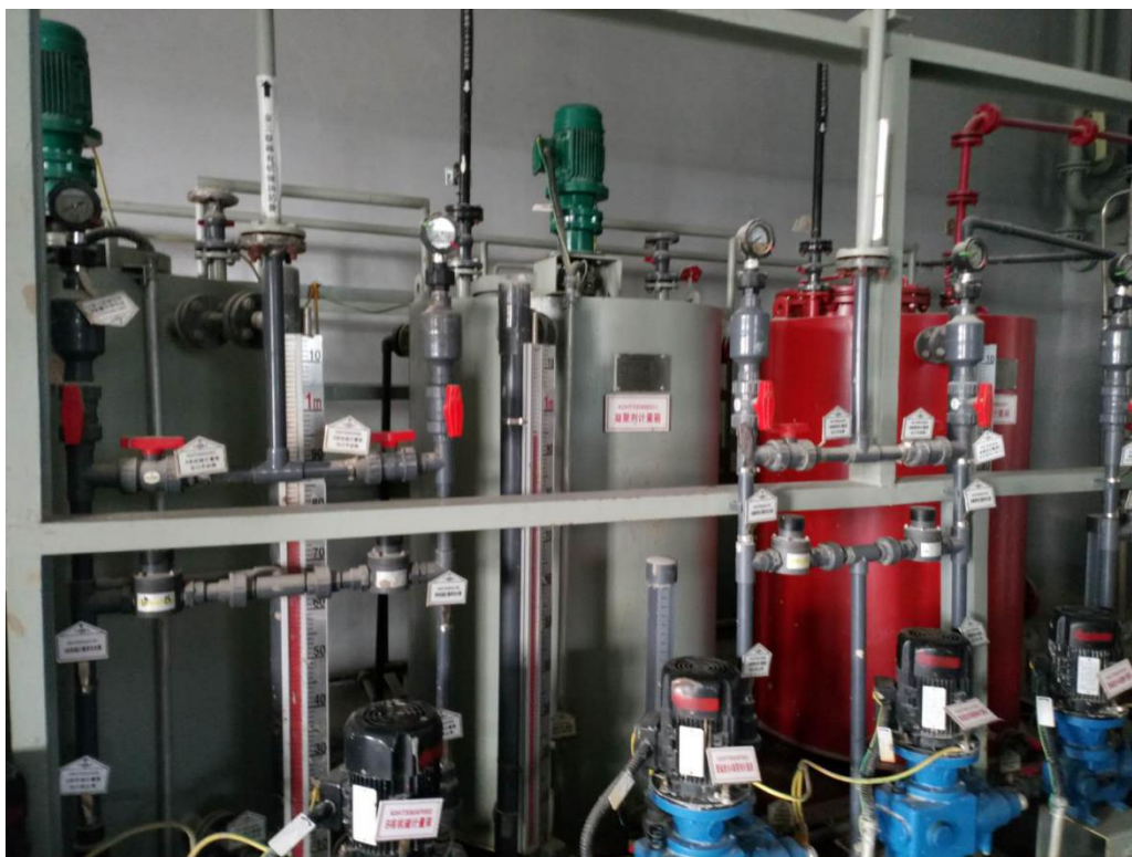
图 4-14 脱硫废水处理设备
