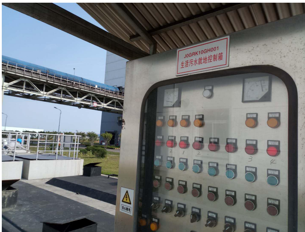
图 4-18 生活污水处理设施
