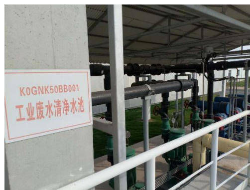
4-12 工业废水处理车间
